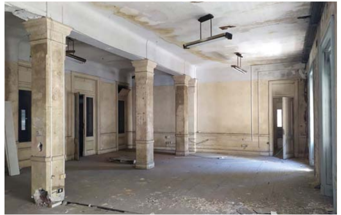
La espacialidad y materialidad de este local se mantuvieron relativamente intactas. Se observan algunas roturas, resultados de cateos realizados, y un deterioro notorio, con pérdida de material en cielorrasos, humedades e instalaciones impropias (artefactos, tendidos externos).
